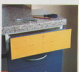
14 Изготовив шаблоны для сверления отверстий, вы получите отличный результат. Шаблоны вырезать из картона, зафиксировать склеив ленточкой.
